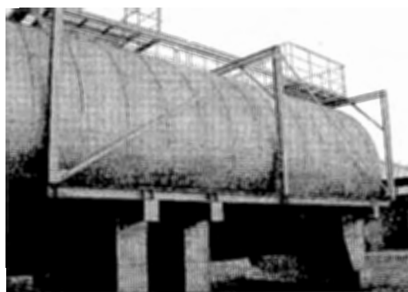
写真13 バイオガスプラント
