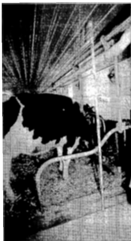
写真5 牛乳処理室側ミルク配管高サ 1800m/m
