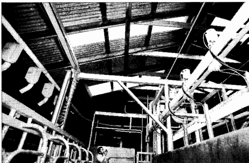
写真49 搾乳室 天井, 断熱材も無い建物
